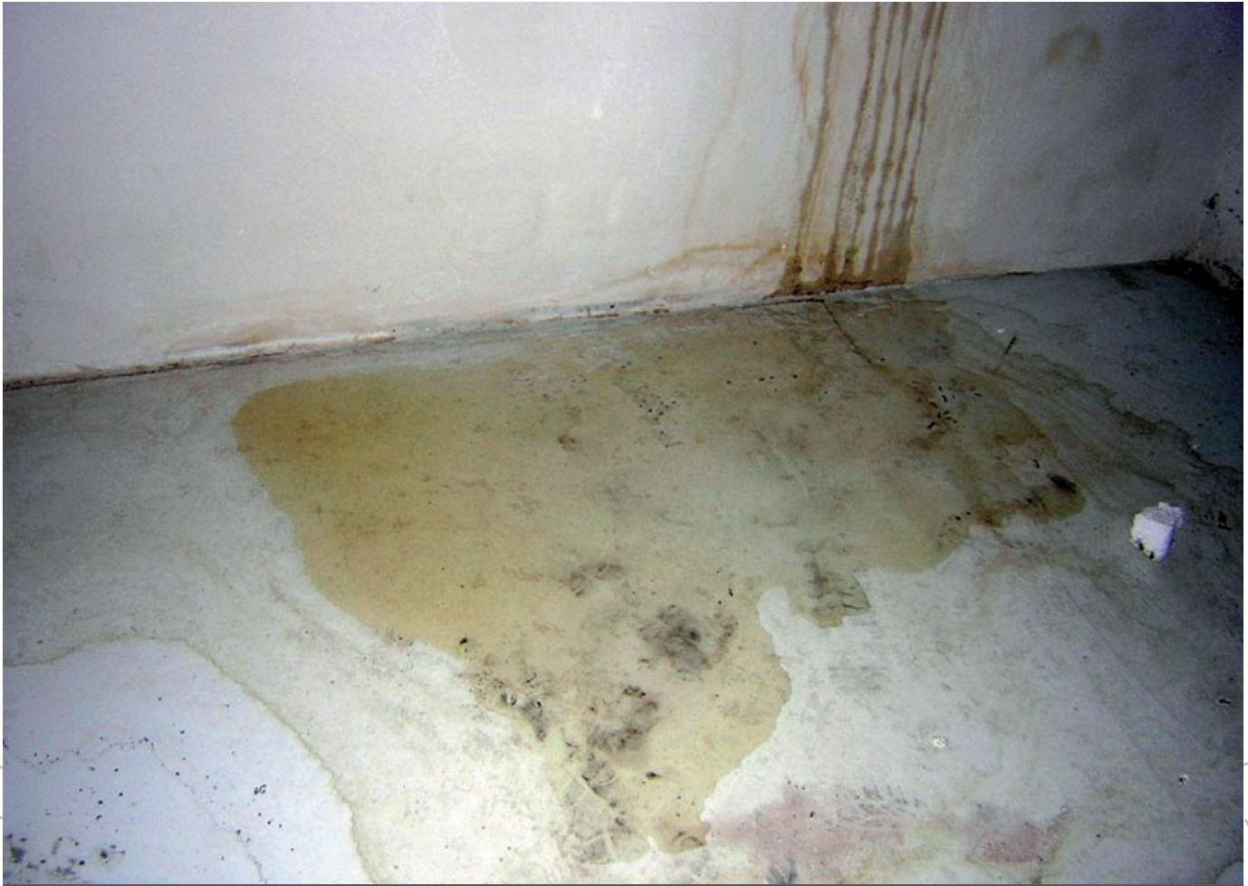
Humedades detectadas tras el ensayo
