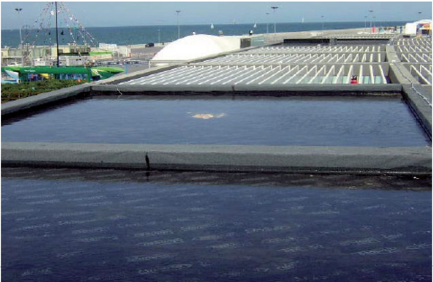
Ejemplo b) Detalle de la cubierta inundada
